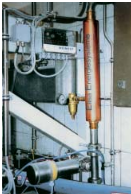
◀ Abb. 2: Einbausituation in Bäckerei.
